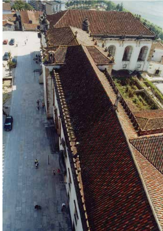
Perspectiva da cabeceira da Capela, observando-se o alteamento produzido pela implantação da nova cimalha (DGEMN, foto 178).
