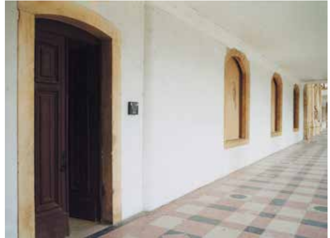
Aspecto da fractura existente entre a Sala Grande e a guarda-roupa no interior da Via Latina .
