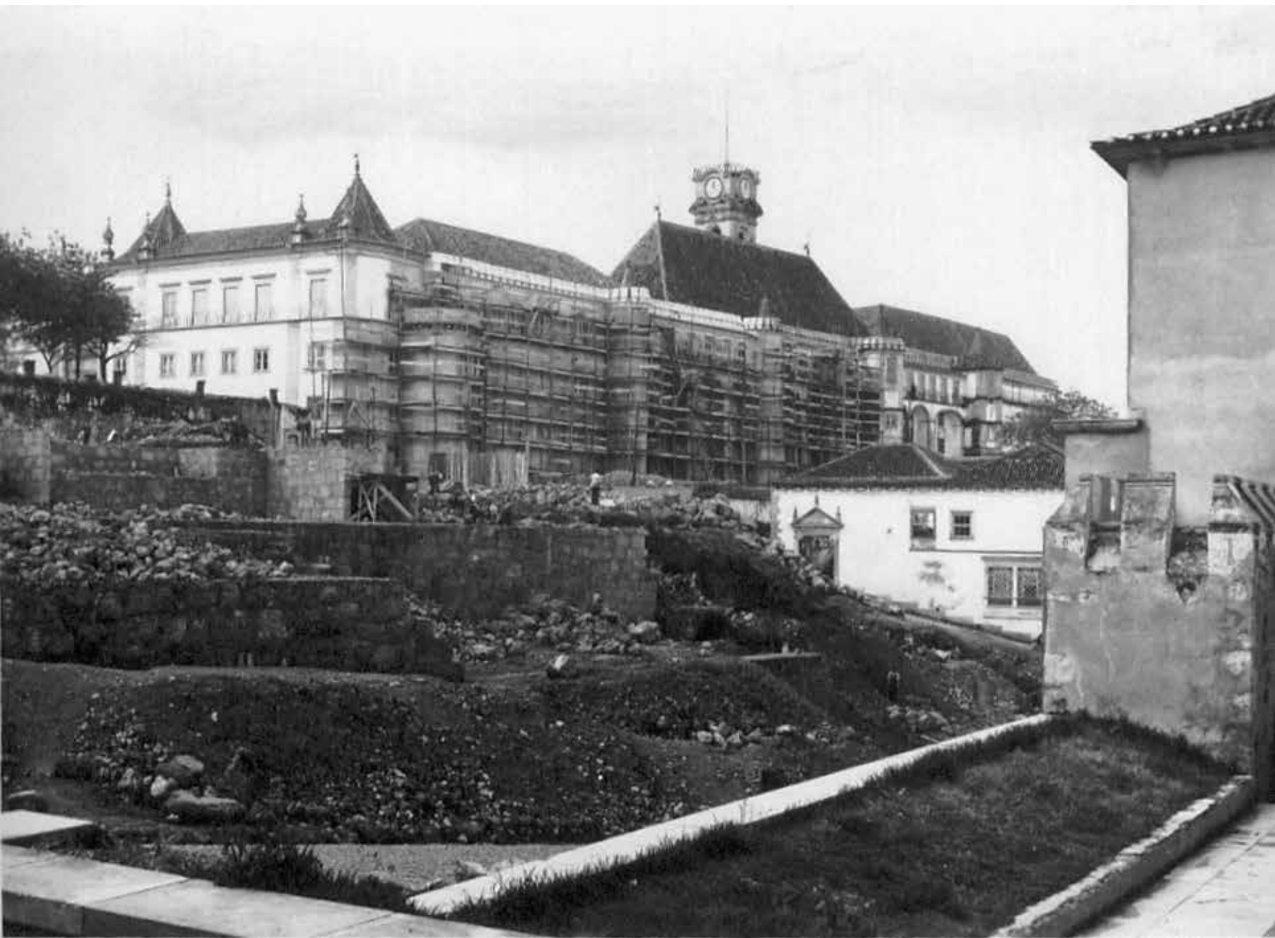
Aspecto das obras de restauro do Paço das Escolas na década de 1940 (DGEMN, foto 208).
