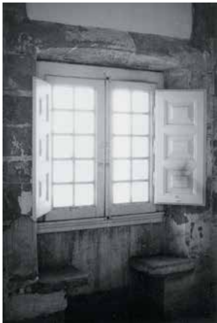
Mirante organizado no 4º cubelo (sentido este/oeste) da fachada norte, em associação com a guarda-roupa.
