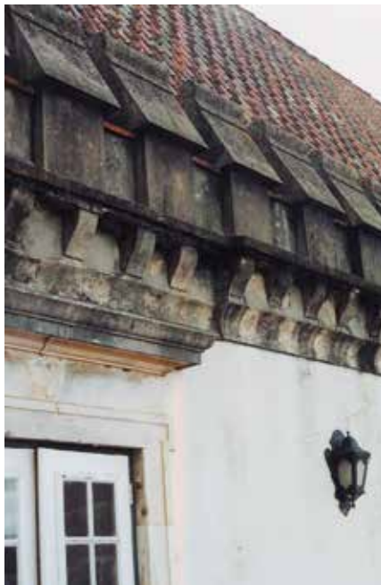
Detalhe da união deficiente da cimalha.
