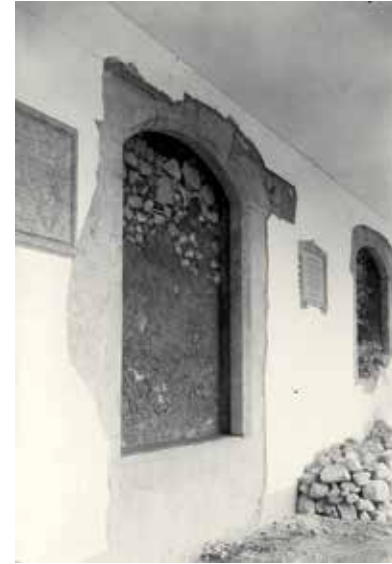
Arcarias do antigo depósito da sala de leitura da Biblioteca, após a demolição deste (DGEMN, foto 516).
