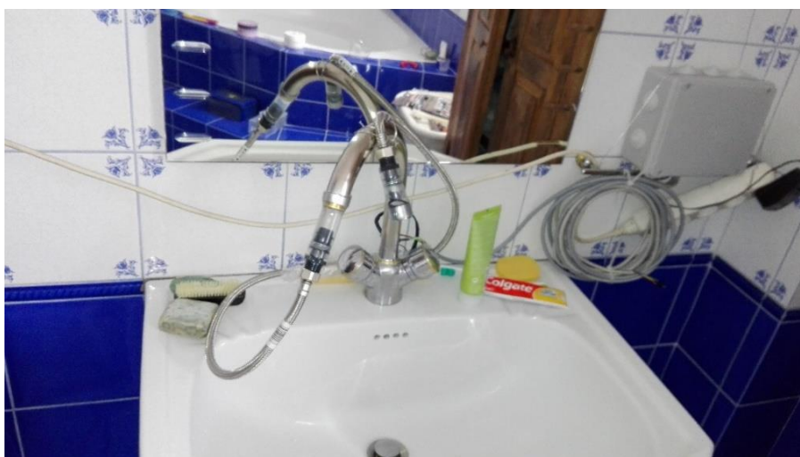
Figura AP. 32 - Instalação do sensor de caudal para o lavatório (edifício de habitação 1).
