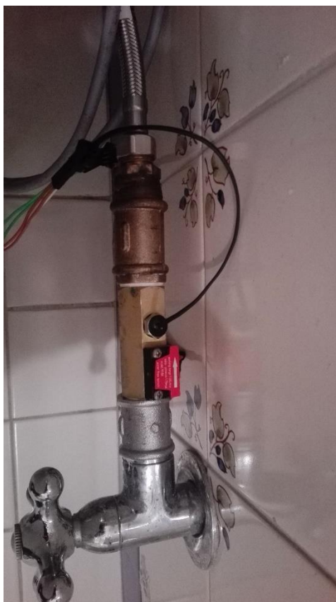
Figura AP. 34 - Instalação do sensor de caudal para o autoclismo (edifício de habitação 1).
