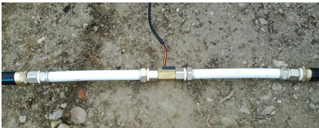
Figura AP. 31 - Instalação do sensor de caudal para a máquina de lavar roupa, rega de jardim, lavagem de veículo e lavagem de pavimentos (edifício de habitação 2).
