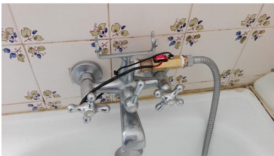
Figura AP. 33 - Instalação do sensor de caudal para o banho (edifício de habitação 1).
