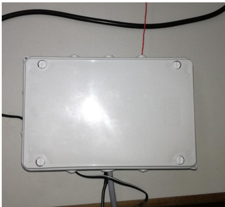
Figura AP. 22 - Montagem do sistema de leitura e transmissão dos dados na caixa estanque (3).
