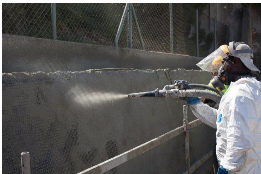
Figura 2.19 – Reforço do paramento frontal do muro da Rua Damasceno Monteiro, com aplicação de argamassa (@construcaomagazine, 2017)
