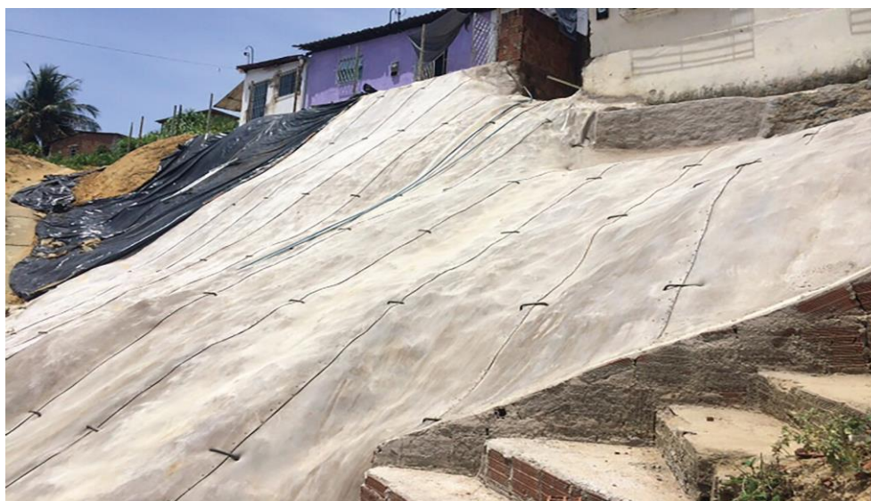
Figura 2.20 – Demonstração da impermeabilização de um talude com manta geossintética de cimento composto (@concretcanvas, 2016)
