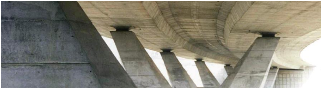
Figura 4.1 – Transição entre o tabuleiro de ponte e os pilares através de apoios elastoméricos (Fonte: fercanorte@)
