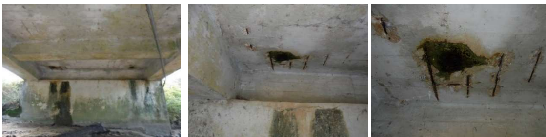
a) Vista geral b) Negativo de drenagem c) Destacamento do betão, armadura exposta
