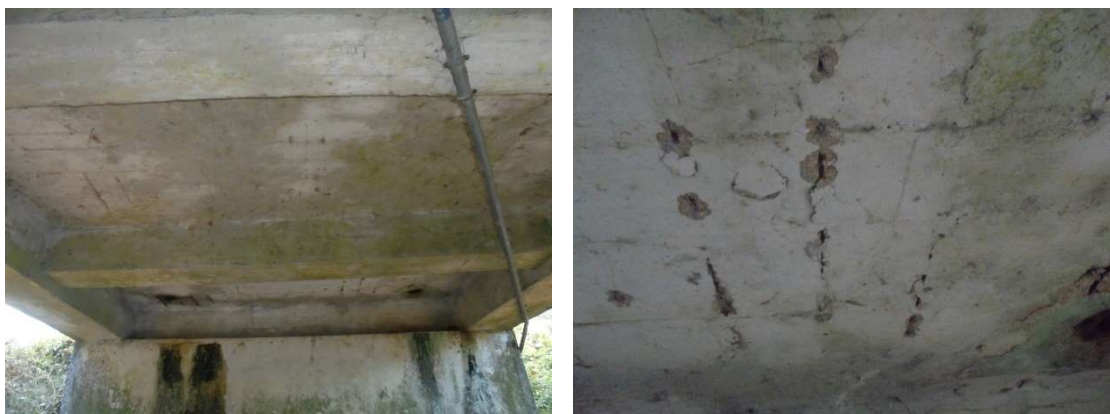
a) Vista geral da face inferior do tabuleiro b) pormenor do destacamento do betão
