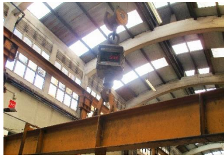
Figura 6.7. Colocação de uma balança na ponte rolante alocada ao jato de granalha
