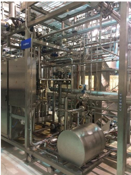
Figura 5.4 Vista parcial da Central Logiface
