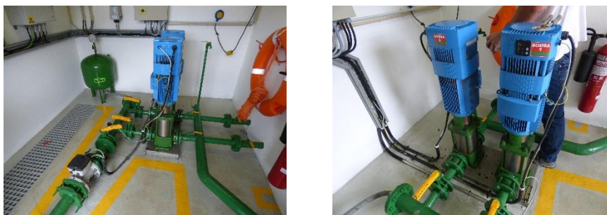
Figura 3.3 – Bomba e reservatório da rede (Águas de Coimbra, 2016)
