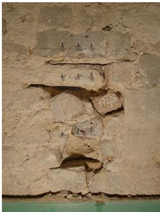
Figura 4.31 – Dano causado pela necessidade de remover os macacos planos presos
