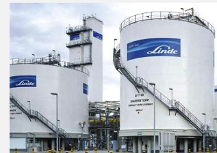
Reservatórios de 1600m 2 de ar líquido, capaz de armazenar 220 MWh
