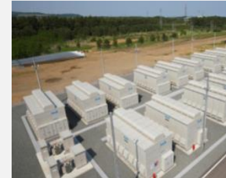
Unidade de 34 MW a operar em conjunto com uma estação eólica (Rokkasho-Futamata, Japão)
