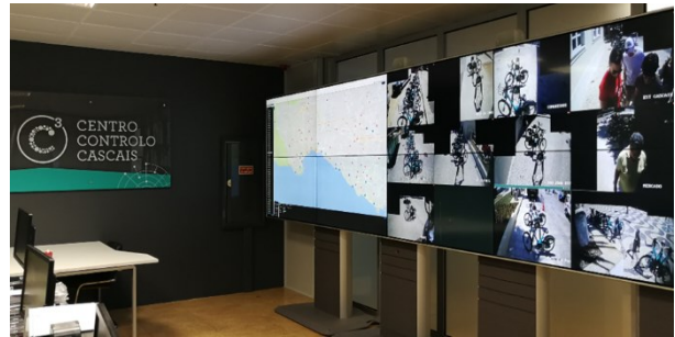
Figura 4.16 C3 - Centro de Controlo de Cascais
