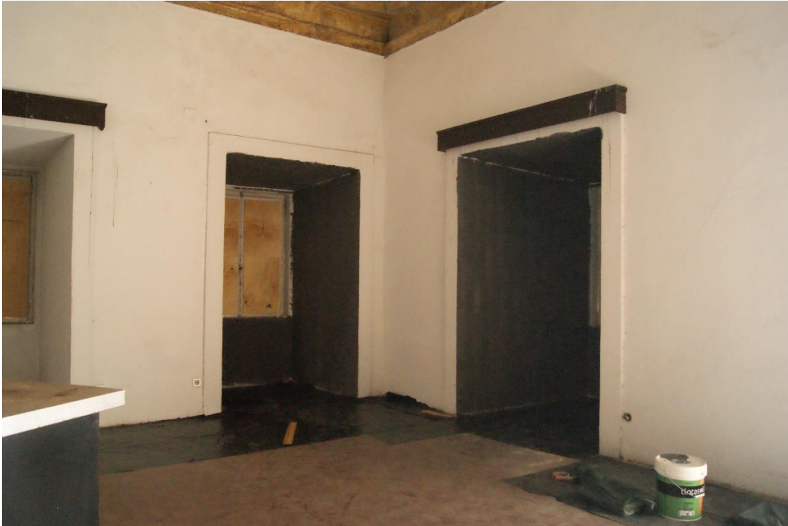
Figura 270 - Montagem da obra "More Sweetly Play the Dance" de William Kentridge no torreão sul. Fotografia da autora.
