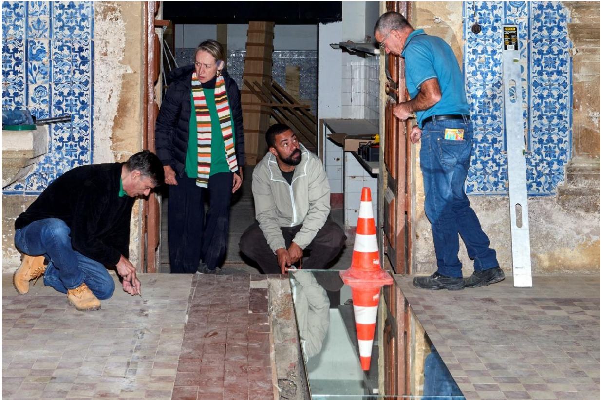
Figura 146 - Montagem da obra da artista Fernanda Fragateiro na ala poente do Mosteiro de Santa Clara-a-Nova. Fotografia de Vitor Garcia. Fonte: CAPC.
