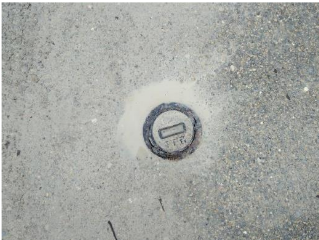
Figura 26 - Piezómetro S3(Pz), com tampa de proteção.
