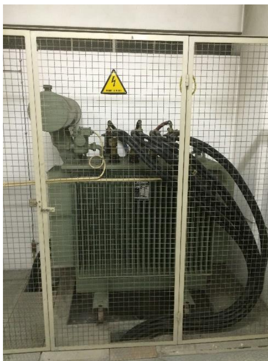
Figura 10 - Transformador principal do PT do edifício DEEC
