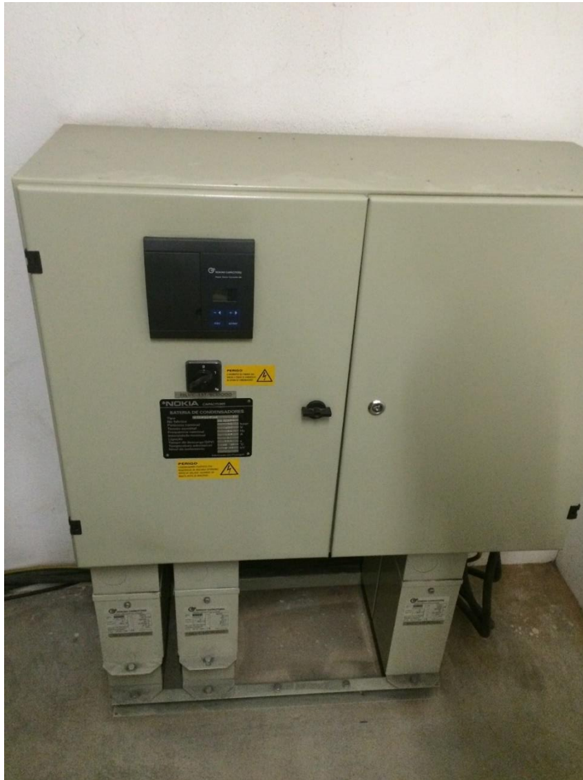
Figura 13 - Bateria de condensadores do edifício DEEC
