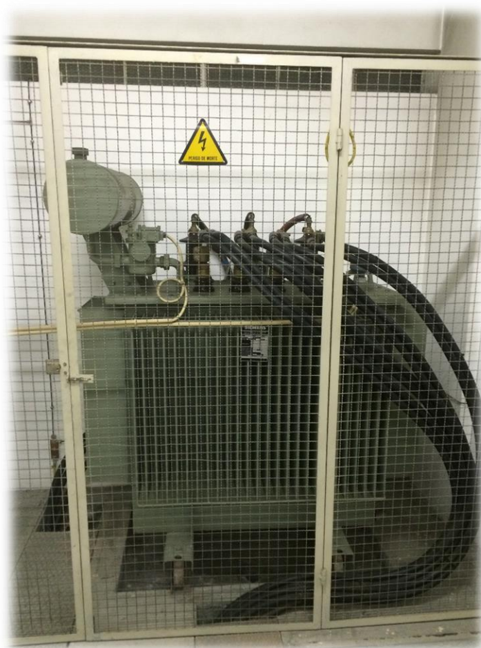
Figura 11 - Transformador n° LEL 46520
