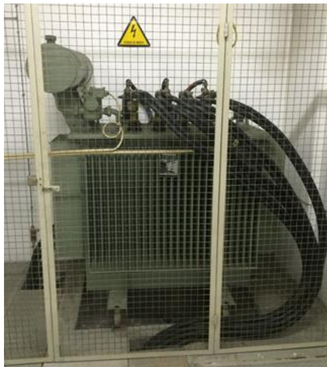
Figura 4 - Transformador principal do PT do edifício DEEC
