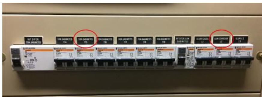
Figura 6- Excerto do quadro elétrico Q3.3.P do edifício DEEC
