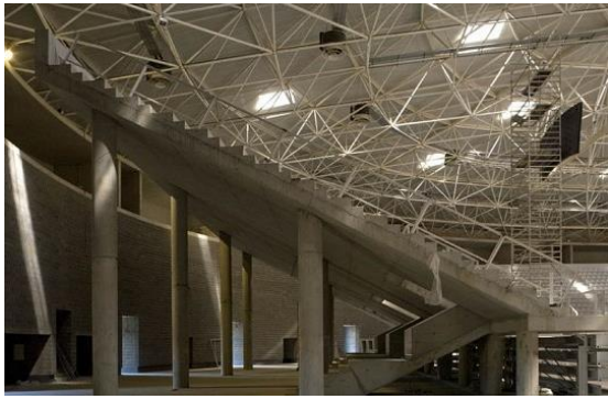
Figura 16 – Estrutura da bancada
