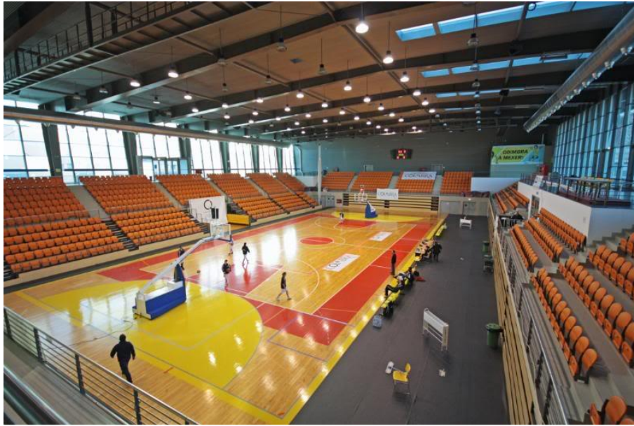
Figura S – Sistemas de ventilação, aquecimento e arrefecimento na cobertura (Pavilhão Multidesportos Dr. Mário Mexia, Coimbra)
