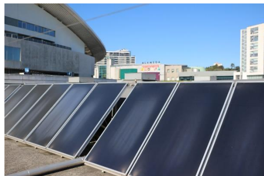
Figura 35 – Painéis solares da cobertura
