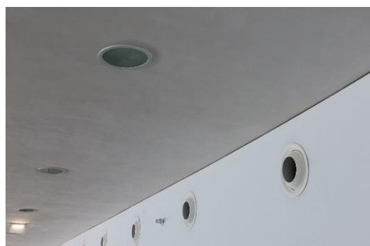
Figura 75 – Luminárias e extractores
