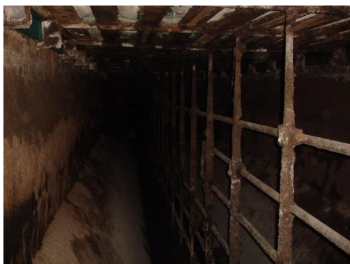
Figura 3 – Interior do reator anaeróbio
