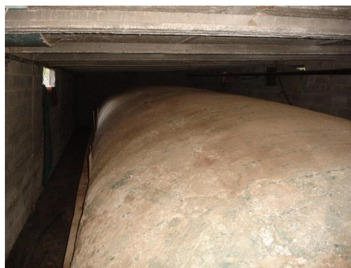
Figura 4 – Reator anaeróbio totalmente preenchido com biogás
