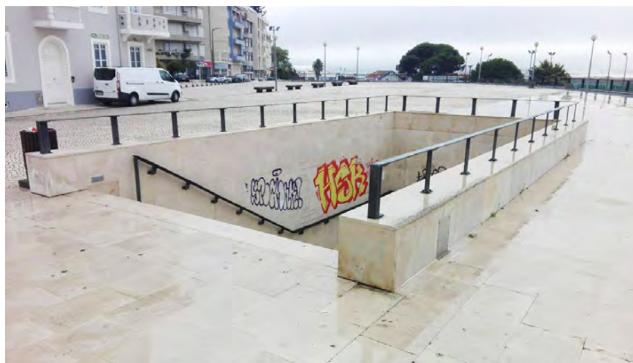
165 | Escadas sem referência tátil, num espaço público, Figueira da Foz
