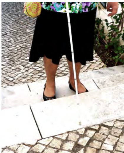
94 | Diferença de pavimentos, nos degraus exteriores, Conservatório de Música de Cascais
