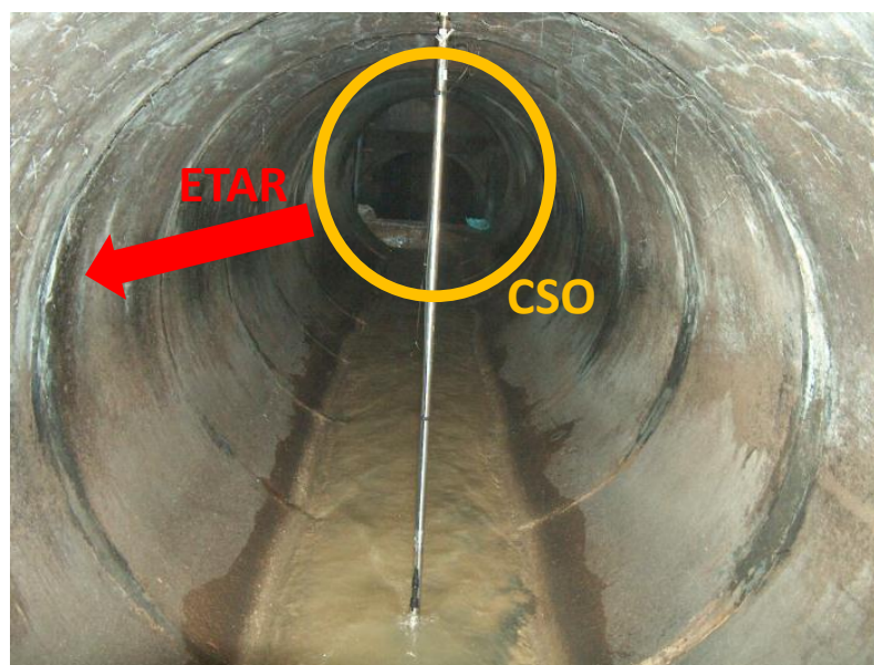
Figura 3.5 – Registo fotográfico efetuado no interior do coletor a montante do CSO (cortesia de Nuno Simões).
