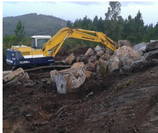
Imagem 3. Obras sem licença em Carapitotas, outubro de 2015. Fonte: A Nossa Terra.
