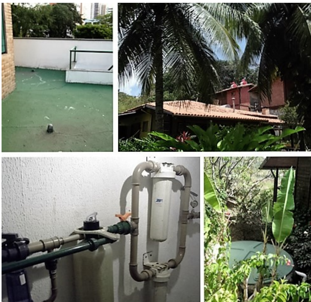
Fotografias 5 - Sistemas de recolha, armazenamento e tratamento de águas pluviais em diferentes hotéis.
