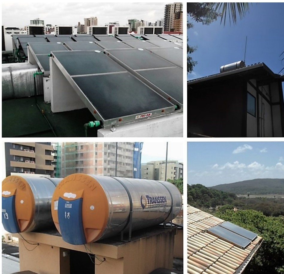
Fotografias 4 - Sistemas de aquecimento de água solar de diferentes escalas instalados em empreendimentos turísticos brasileiros.
