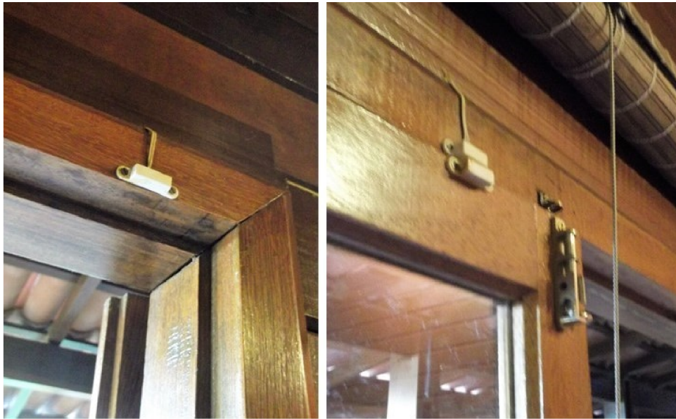
Fotografias 22 - Sistema de corte do ar condicionado por abertura de portas ou janelas, numa Pousada em Fernando de Noronha, Brasil.
