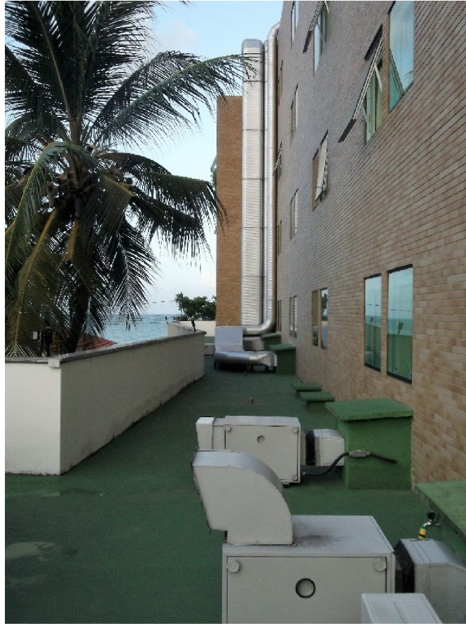
Fotografia 6 - Sistema de ar condicionado central em hotel na Paraíba, Brasil.
