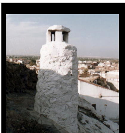
Fig. 17 – Chaminé de ventilação de habitação troglodita
