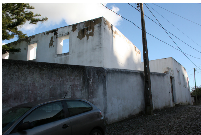
Fig. 48 - Perspectiva exterior – Ângulo superior Fig. 49 - Perspectiva exterior – Tensão entre paredes Fig. 50 - Perspectiva exterior – Muros exteriores
