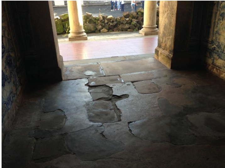
Figura 13 - Igreja de São Francisco – Piso danificado da área de acesso à sacristia e à Igreja.
