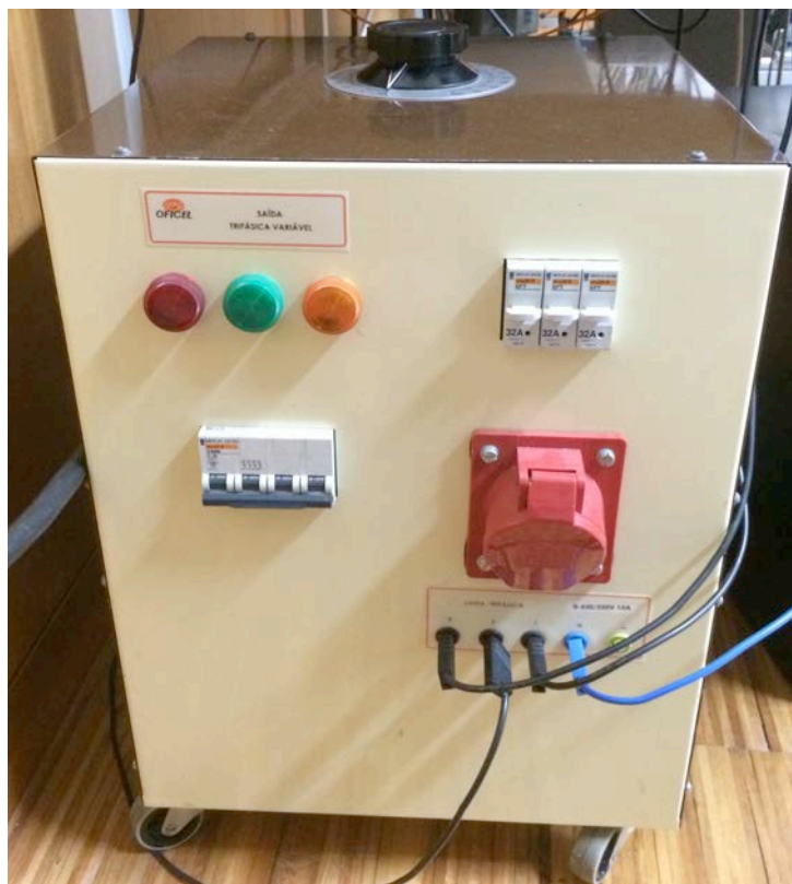
Figura B.6: Autotransformador usado para regular a tensão da rede
