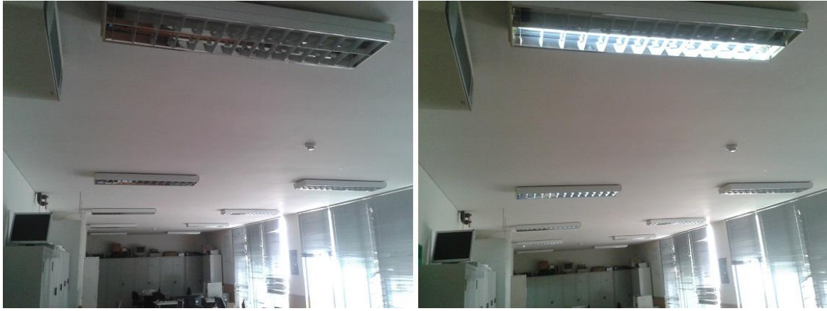
Figura 49: Iluminação principal do Laboratório de Gestão de Energia.
