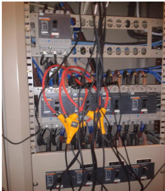
Figura 32: Montagem do equipamento Fluke 1735 na saída do Quadro da Torre R para o Piso 5.
