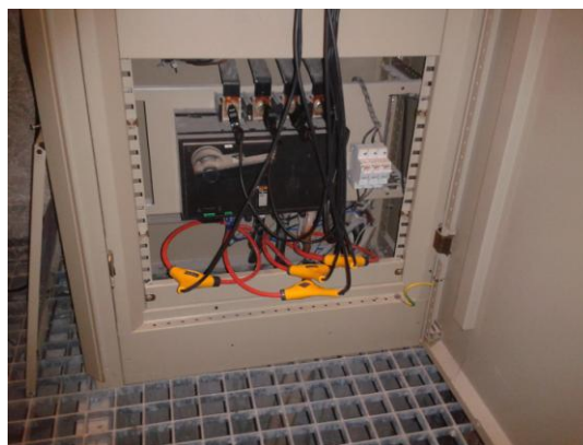
Figura 37: Montagem do equipamento Fluke 1735 entrada do Quadro do Piso 5 da Torre R do DEEC.
