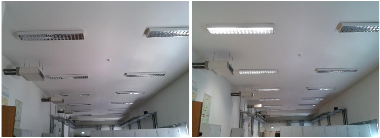
Figura 38: Funcionamento da iluminação principal do Laboratório de Sistemas Eletromecânicos.
