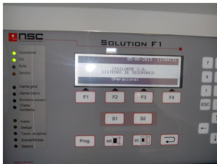
Figura 78 - Aspeto da CDI operacional.
