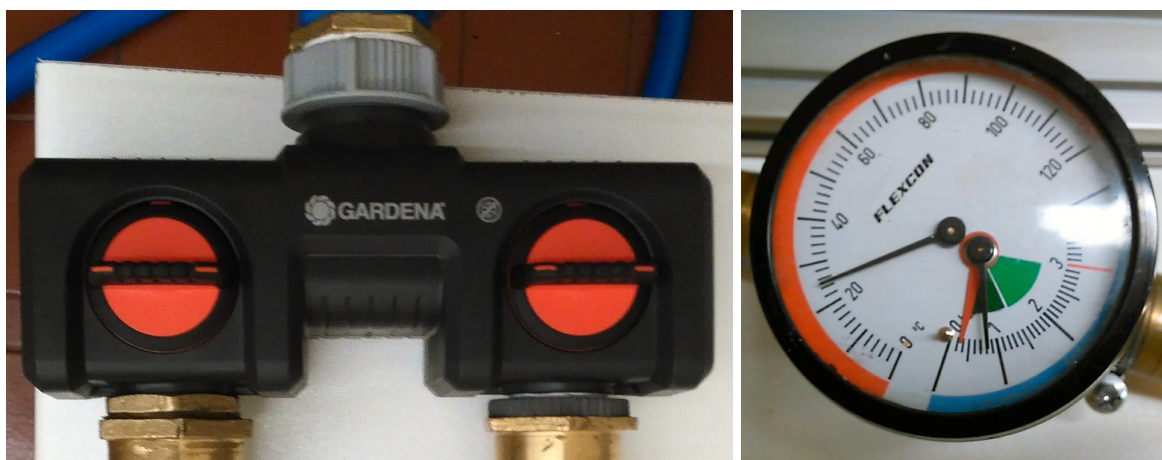
Figura 3.5: Distribuidor Gardena para controlo de caudal (esquerda) e dispositivo de leitura de pressão e temperatura (direita).
