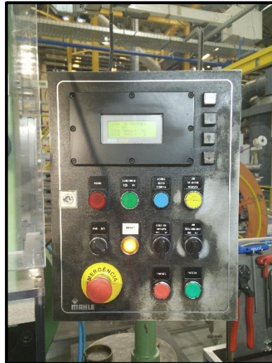
Figura 19 - Controlador PLC da Enroladora
