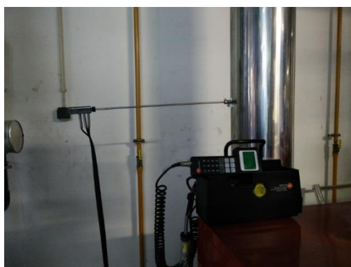
Figura 3.3-Pormenor de instalação do analisador de gases.
