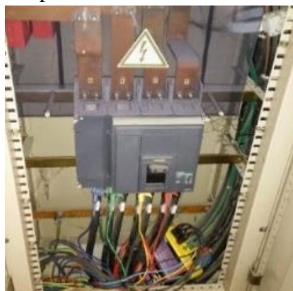
Figura 3.2-Pormenor da instalação de analisadores de energia no Quadro Geral do CMPL.
