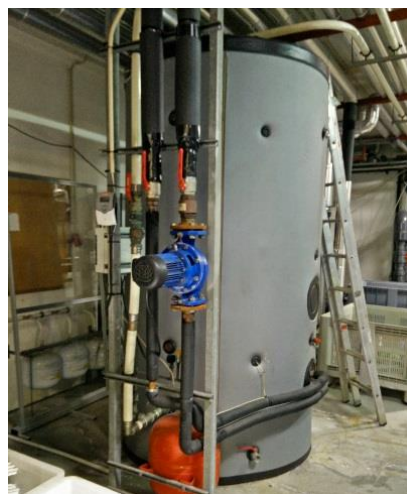
Figura 3.7- Depósito de inércia e controlador solar dos coletores solares.
