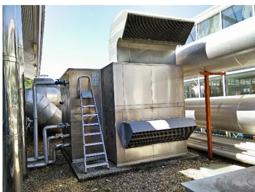
Figura 3.8- UTA da Nave B.
