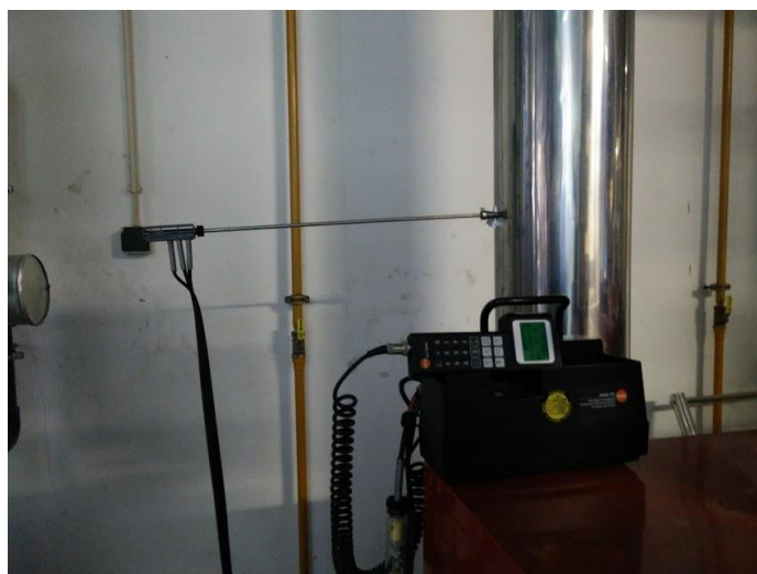
Figura 3.32- Pormenor de instalação do analisador de gases
