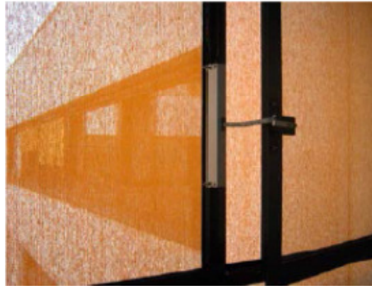
Figura 13 - Instalação experimental de sensores de CO 2 e humidade para janelas com actuadores motorizados numa sala de aulas da Universidade de Lyon (Fonte: El Mankibi et al. , 2011)
