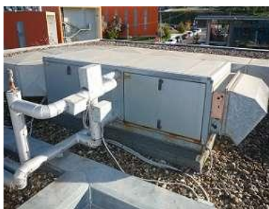
Figura A.5 - UTAN na cobertura (R.P., 2013)
