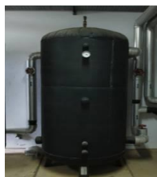
Figura A.3 - Reservatório de água
