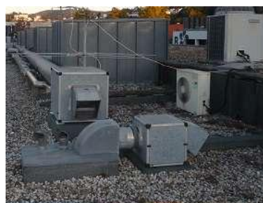
Figura A.6 - 1º Plano: Ventilador de extração dos sanitários; 2º Plano: Ventilador de extração do corredor (R.P., 2013).
