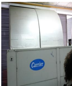
Figura A.1 - Chiller
