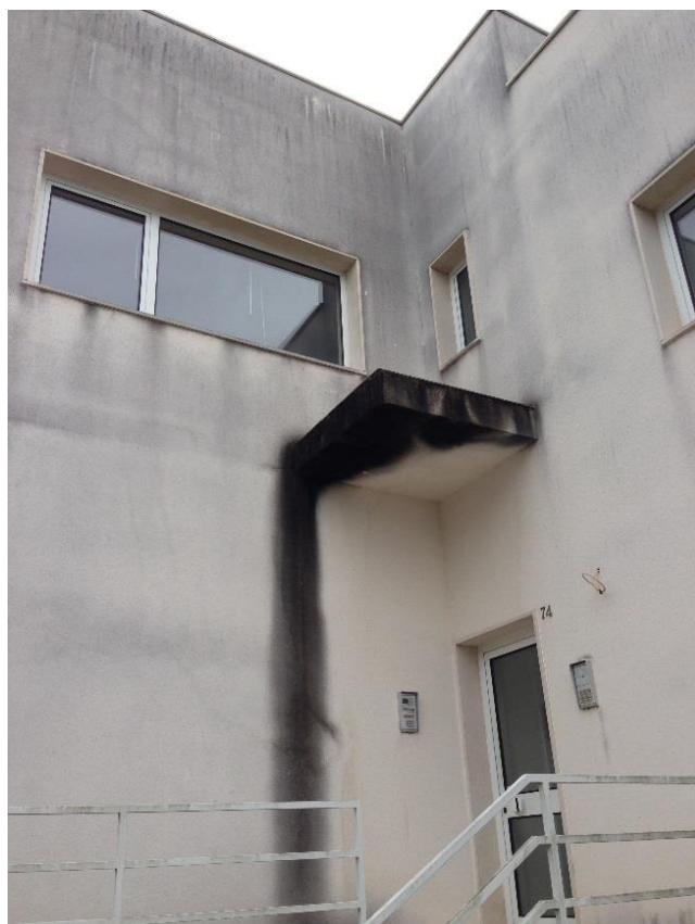
Figura 3.2 – Degradação de reboco e pintura devido à falta de drenagem de águas (edifício em Coimbra)
