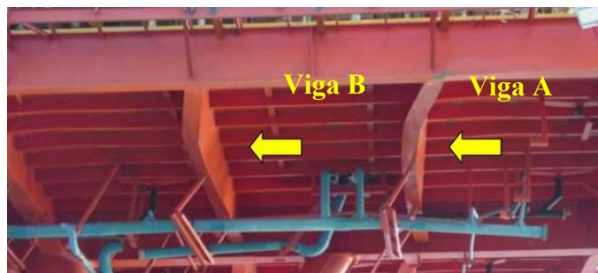
Figura 2.8 – Deformações provocadas pela tempestade no deck da plataforma [35].
