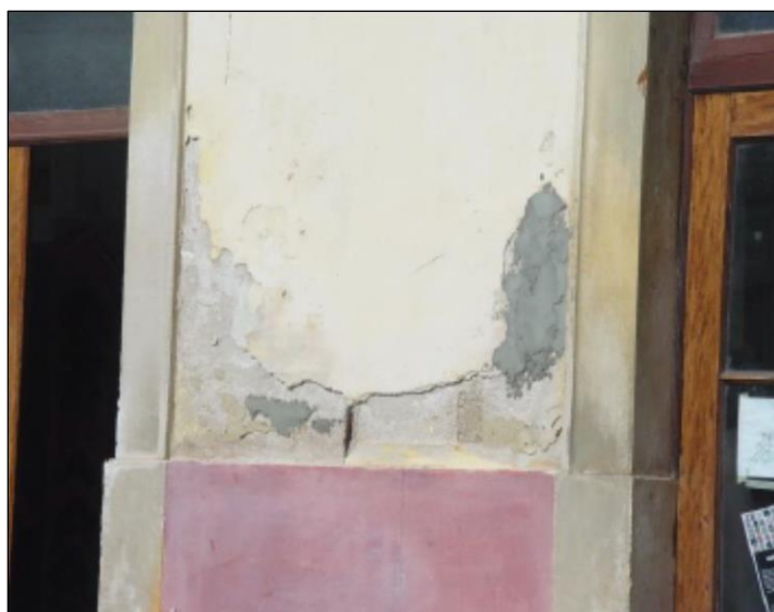
Figura 2.2- Incompatibilidade de reboco antigo à base de cal com reparação através de cimento Portland (Silva, R. (2009)).
