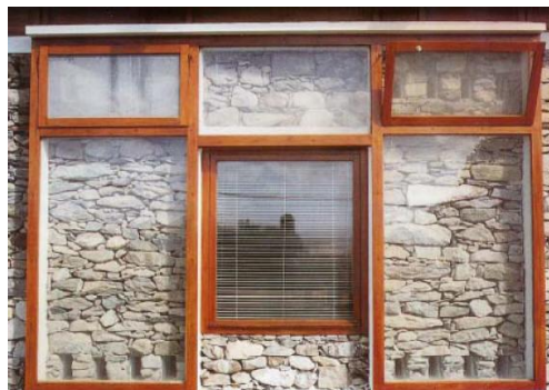
Figura 3.3 – Parede de Trombe. Casa Shäffer, Porto Santo (Gonçalves e Graça, 2004).
