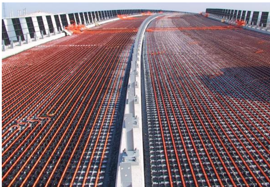
Figura 2.1 – Coletor solar aplicado numa ponte em Roterdão (Holanda)
