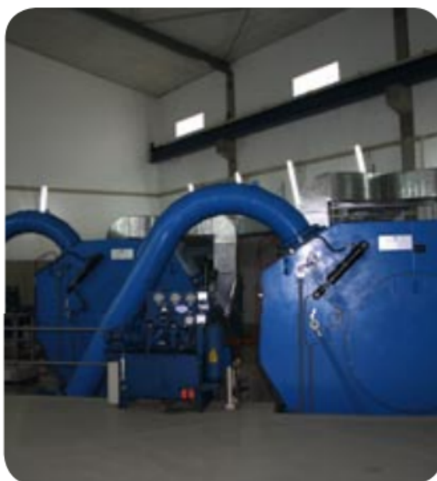
Figura 5.5 – Turbinas Pelton colocadas no aproveitamento hidroelétrico do Catapereiro
