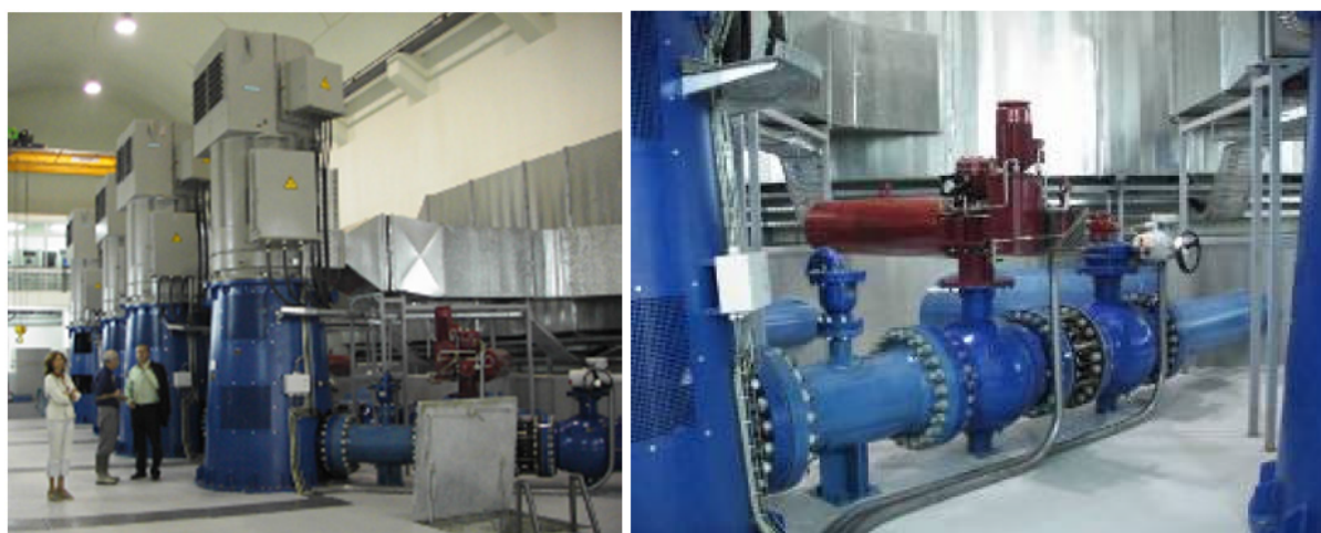
Figura 2.16 – Grupos elevatórios e válvula de segurança (Ramos, 2014)
