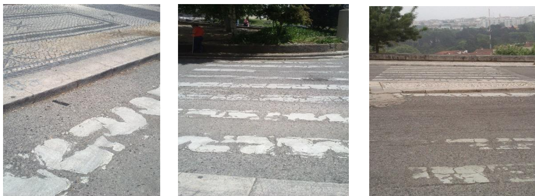
Figura 3.2 - Passeios sem rampas e marcações rodoviárias deficientes
