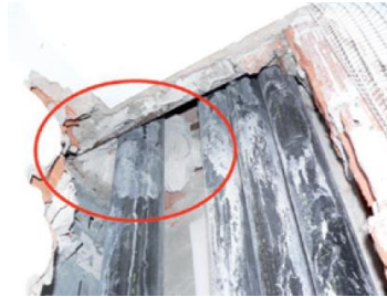
Figura 4.19 – Tubagens com resíduos de argamassa (COST, 2014)
