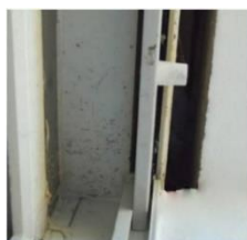
Figura 4.15 – Abertura de elevada espessura entre a caixa de estore e a parede de fachada (COST, 2014)
