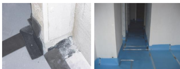
a) Execução incorreta
