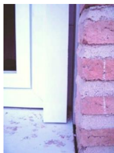
Figura 4.13 – Má execução da junta entre o caixilho da janela e a parede de alvenaria (COST, 2014)
