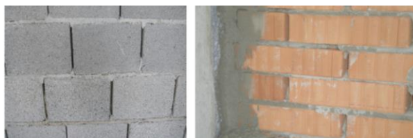
Figura 4.6 – Falta de argamassa nas juntas verticais da alvenaria (COST, 2014)
