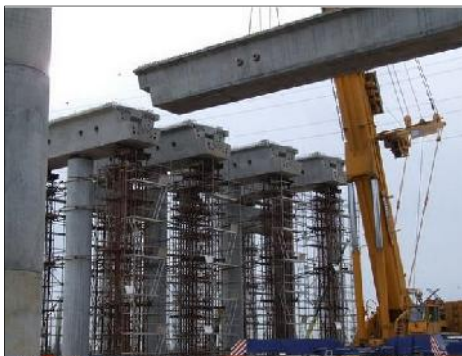
Figura 2.1 – Viaduto executado com recurso a vigas em caixão indentadas (Viegas e Saraiva, 2010).
