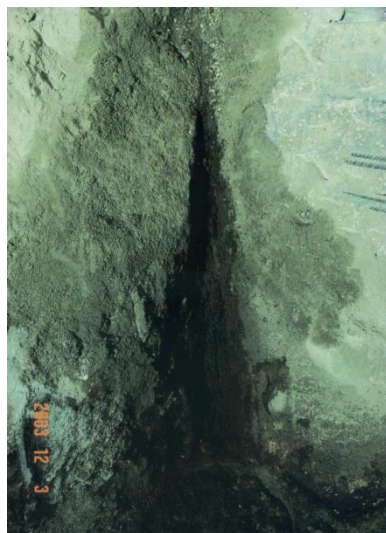
Figura 2.18 – Pormenor de duas estacas desalinhadas (cortesia do professor Jorge Almeida e Sousa – DEC/FCTUC)
