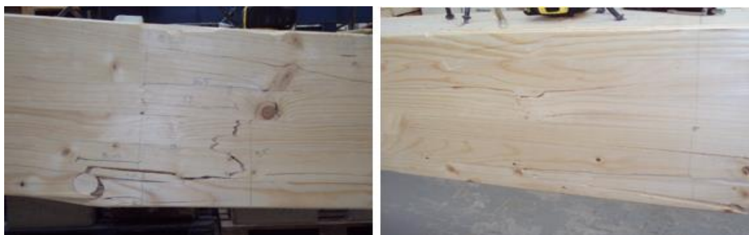
Figura 3.6 - Fissuras da Viga 5
