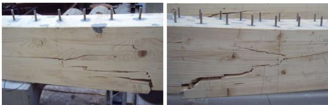
Figura 3.5 - Fissuras da Viga 1
