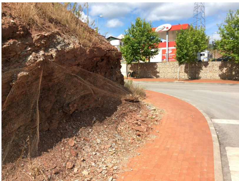
Figura 4.6 – Pequeno desmoronamento de um talude.
