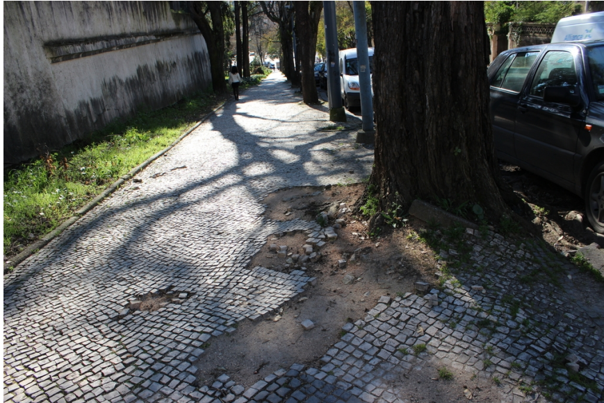
Figura 4.9 – Irregularidades no passeio e parque de estacionamento causadas pela raiz de uma árvore.
