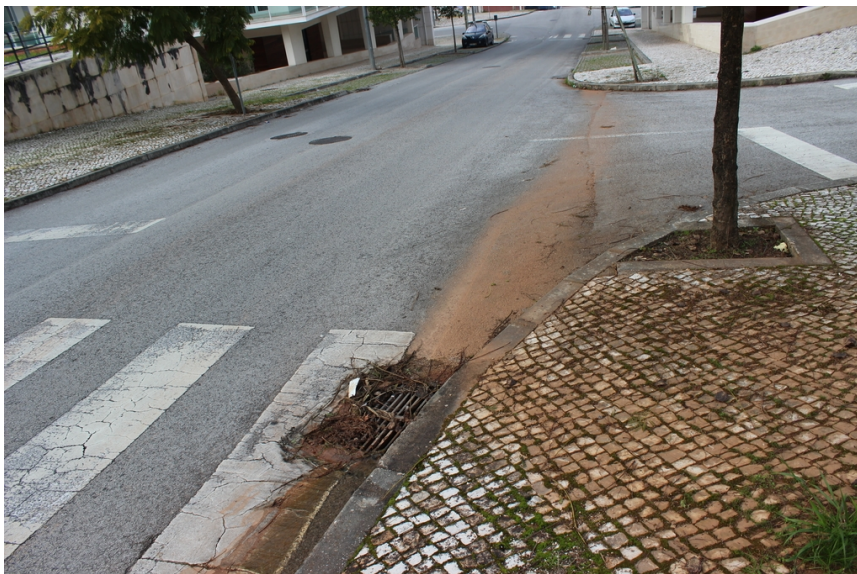
Figura 4.5 – Acumulação de lixo num sistema de drenagem.
