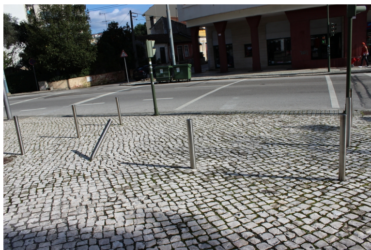
Figura 4.7 – Pilarete torto à saída de uma passadeira.
