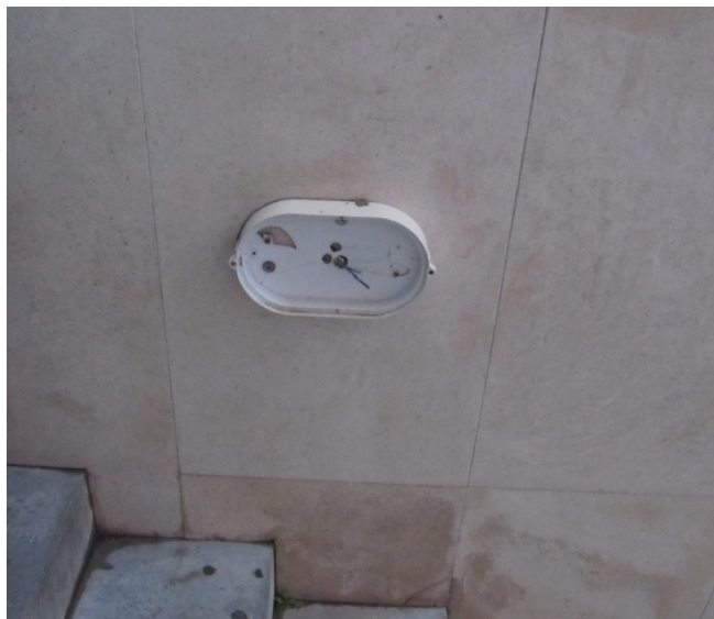
Figura 4.4 – Ausência de lâmpada e fios de ligação expostos.
