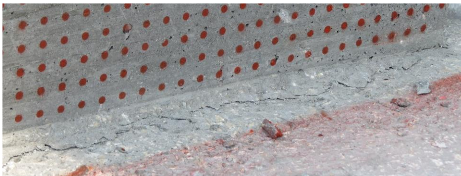
Figura 3.53 - Aparecimento de 'fissura' na interface das duas camadas de betão
