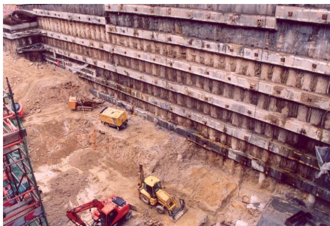
Figura 2.2 – Exemplo de estrutura de suporte flexível constituída por uma cortina de estacas de betão armado suportada por vários níveis de ancoragens pré-esforçadas (Almeida e Sousa, 2007).
