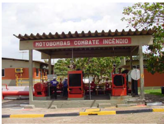
Figura 16. Casa de bomba de incêndio (Fonte: Petrobras Transpetro S.A)
