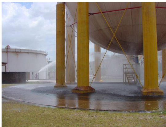
Figura 22. Sistema de esguichos para produção de neblina (Fonte: Petrobras Transpetro S.A).
