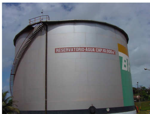
Figura 14. Tanque de armazenamento de água para incêndio, (Fonte: Petrobras Transpetro S.A)
