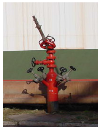
Figura 15. Canhão monitor para lançamento de água e espuma (Fonte: Petrobras Transpetro S.A)
