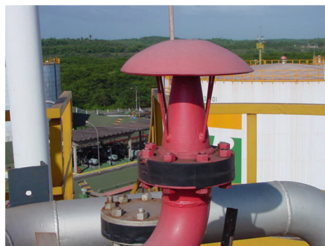
Figura 19. Sistema de refrigeração esferas, (Fonte: Petrobras Transpetro S.A)
