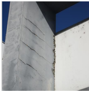
RRG6 - Fissuração grave do reboco
