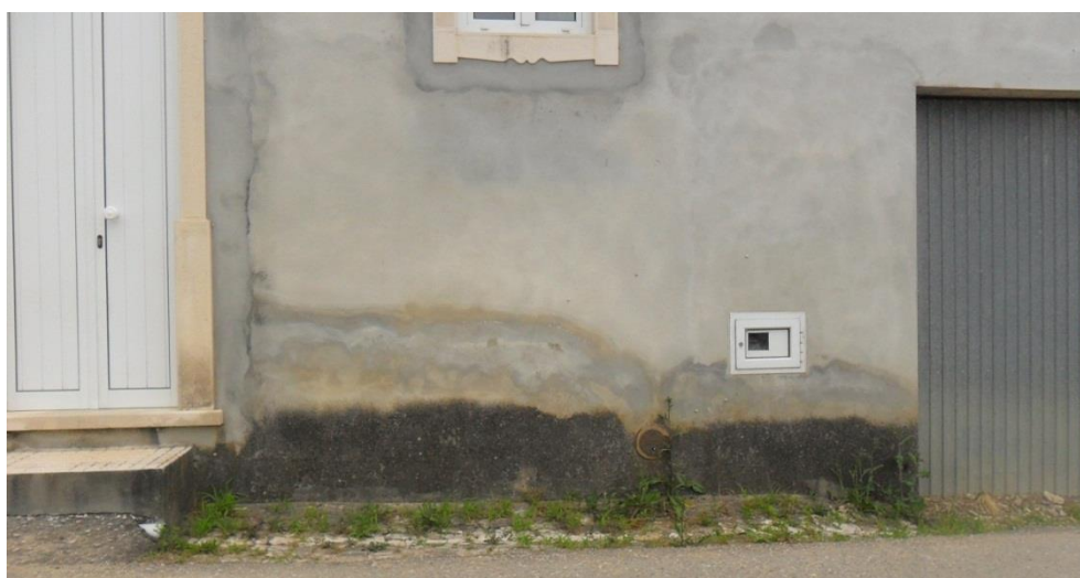
Figura 2.3 – Humidade ascensional, manchas escuras e formação de eflorescências (habitação em Pedrogão, Soure)
