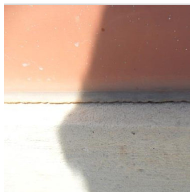
RAG7 – Descolamento do mastique ou material similar do remate das caixilharias ao suporte
