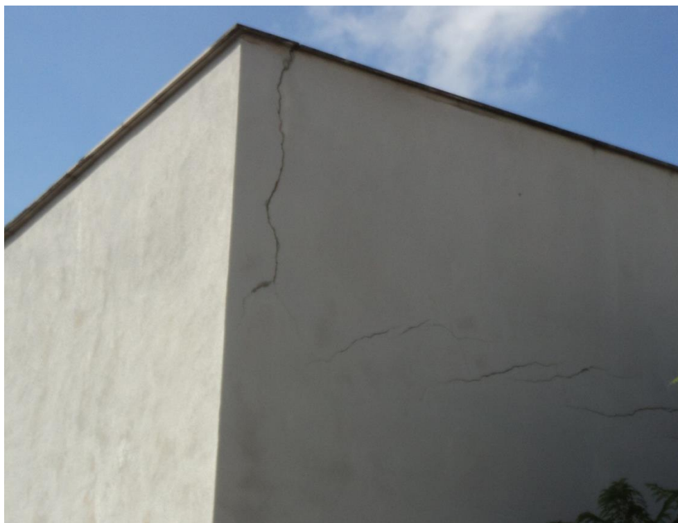
Figura 2.5 – Fissuração em cunhal e em zona de ligação entre platibanda e laje de cobertura
