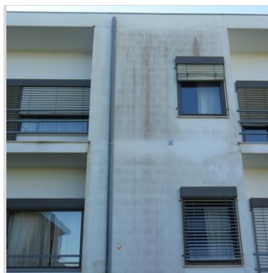
RRG8 - Manchas de sujidade e colónias biológicas (Termoforese)
