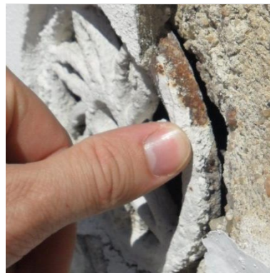
RAG6 – Oxidação das grelhas de ventilação
