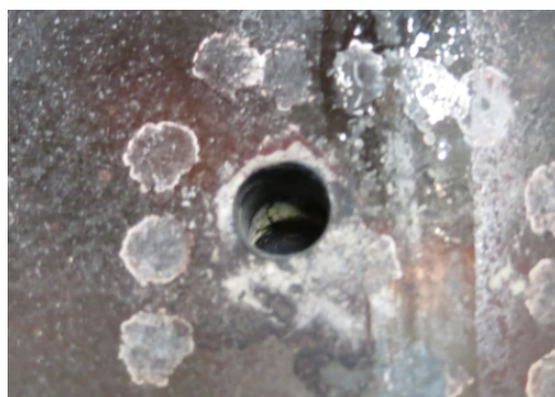
Figura 3.24 – Descolamento do aço e do betão evidenciado num orifício feito para permitir a saída do vapor de água
