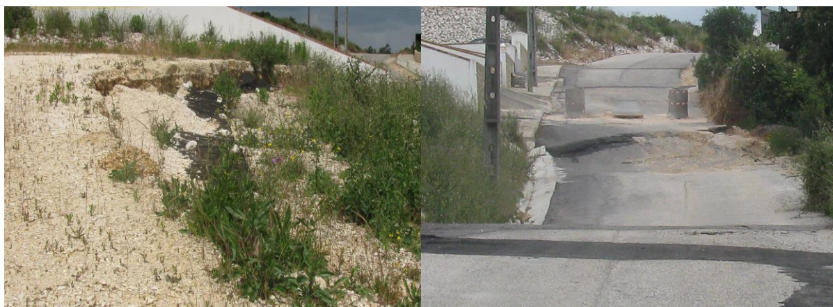
Figura 4.4 – Topo da superfície de rotura observada no local
