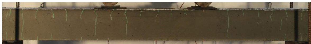
Figura 4.60 – Fendas na Viga CIN-4F6 antes de se iniciar o ensaio.
