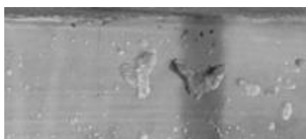
Figura 3.2 – Vazios laterais nas vigas de argamassa.
